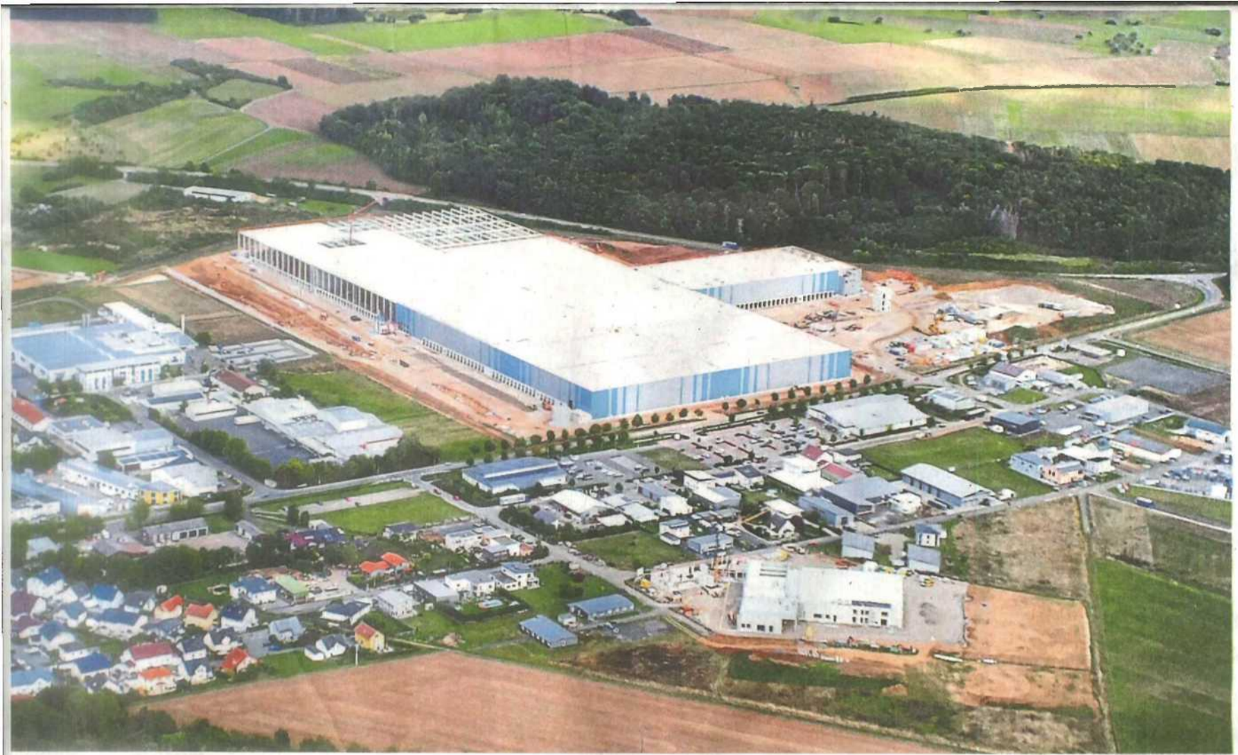
Fünf Monate nach Baubeginn hat das Logistikzentrum an der Langsdorfer Höhe Form angenommen. Noch in diesem Herbst soll die Einmündung der Hungener Straße an die B 457 (rechter Bildrand) umgebaut werden.
