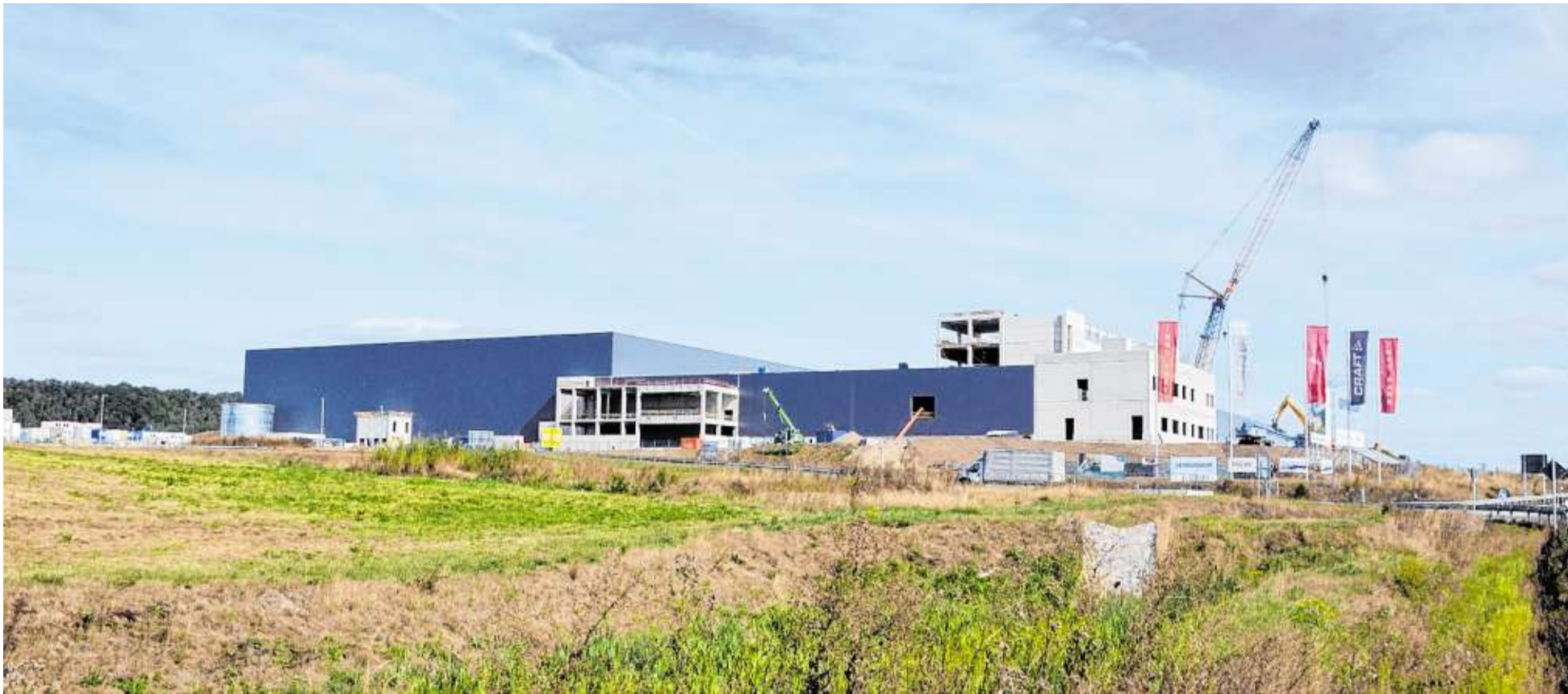
70 000 Quadratmeter groß wird das neue Multi-Channel-Zentrallager von Puma in Geiselwind. Am Donnerstag wurde Richtfest gefeiert.
